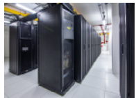
CO. A (DATA CENTER)
